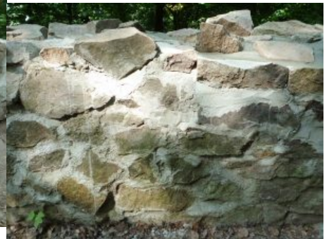
mit Mörtel und Steinen verfüllter Mauerkern
