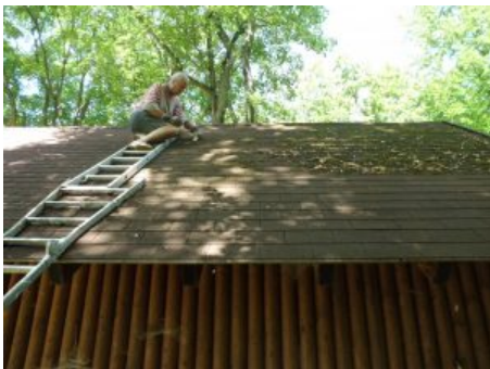
Moosbekämpfung auf der Südostseite der Wanderhütte mit der Stahlbürste
