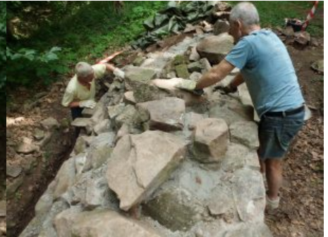
nördliche Ringmauer beidseitig auf 3 m restaurieren
